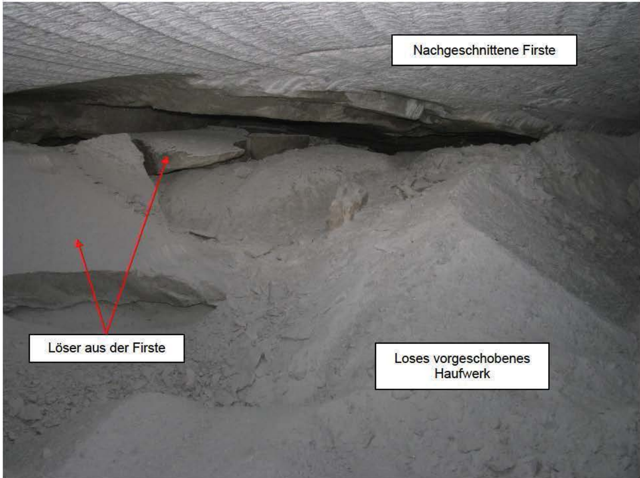
Abbildung 20: Im Firstbereich befindliches Haufwerk und Löser aus der Firste mit Blick in Richtung Osten (Aufnahmedatum: 07.05. 2009).
